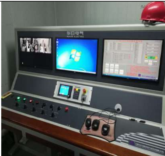
操作室监控装置
